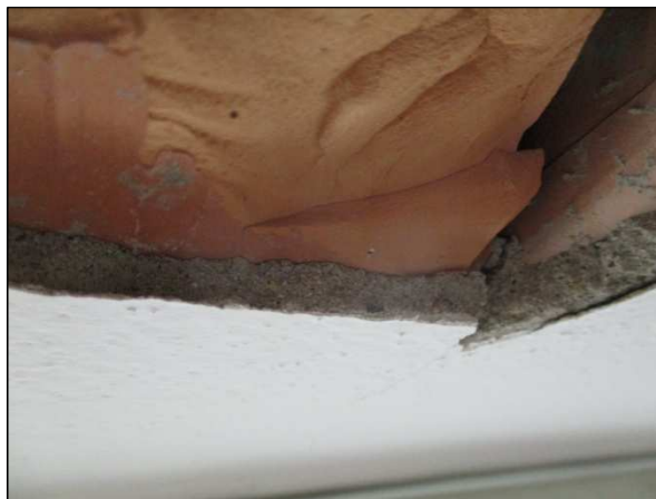
Foto n°11 - Particolare dello spessore dello strato di finitura del plafone.
