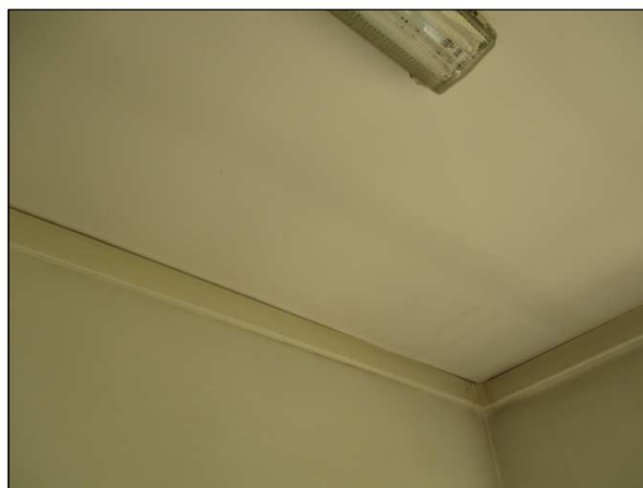
Foto n°14 - Porzione dell'intradosso del solaio del Corridoio al piano terra connotata da una conservazione pessima.
