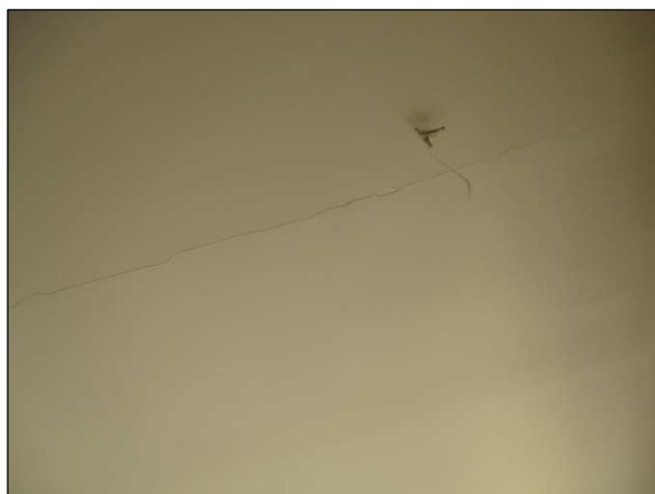
Foto n°13 - Porzione dell'intradosso del solaio del Corridoio al piano terra connotata da una conservazione pessima.
