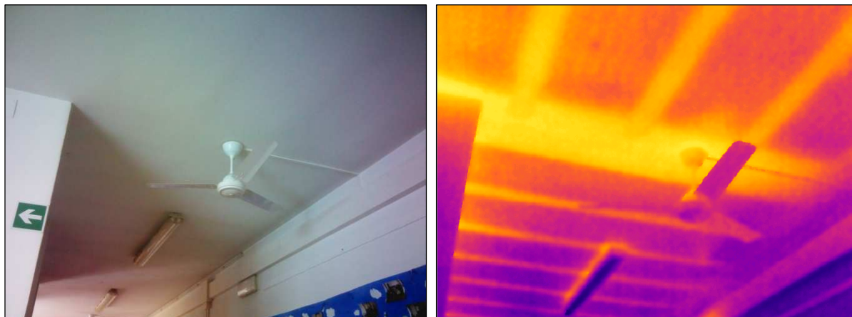
Foto n°5-6 - In corrispondenza dell'innesto del Corridoio con l'Ingresso è facilmente riconoscibile il tracciato caratteristico di una trave confinata nello spessore del solaio che permette la variazione della direzione dell'orditura portante. L'elevata linearità con cui appaiono in tutti i casi i contorni degli stessi travetti è riferibile alla presenza di elementi portanti prefabbricati.
